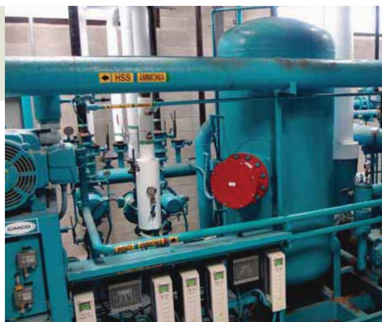
L'imposant panneau de contrôle et un aperçu du système Eco Chill
