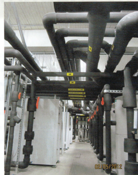
Le salle mécanique
