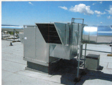
L'unité VRC à roue thermique en toiture
