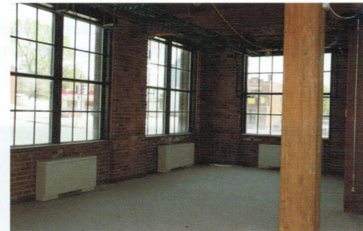
La charge thermique est traitée par les ventilo-convecteurs en périphérie.
