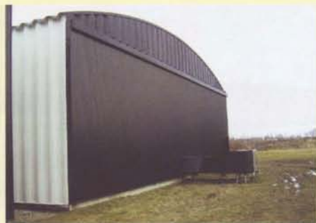
Photo 5: Exemple de collecteur non-vitré au mur couplé avec thermopompe pour le chauffage de l'espace
